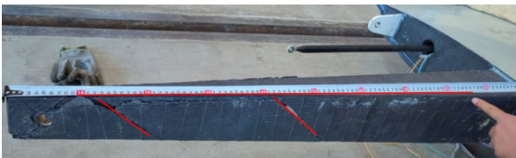
图6 航前方向破损情况 Fig. 6 Damage to the heading direction side
